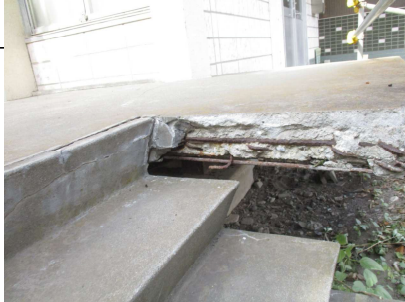
⑩床版欠損・露筋
