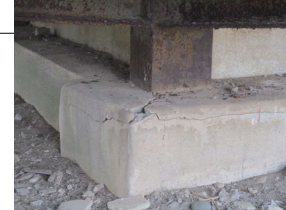
⑪基礎欠損
