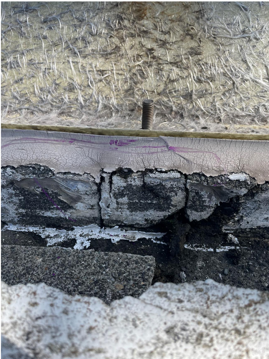
屋根 老朽化が顕著な部分
