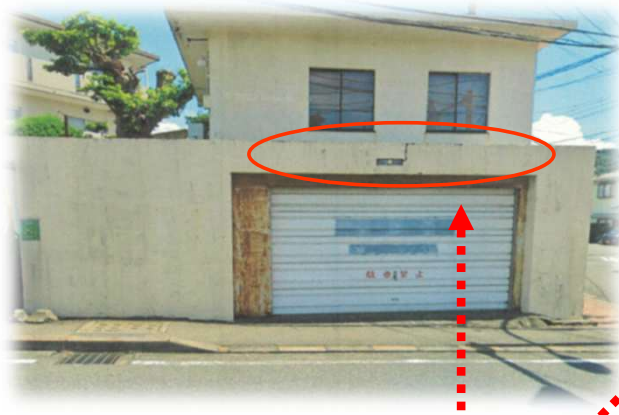
仕上材が浮いている、落下の可能性あり
