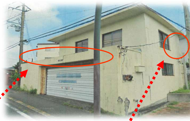
窓ガラスの破損（建物裏）
